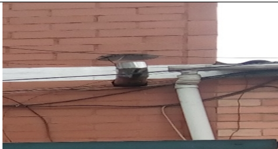
Fotografía N°. 4 Ducto de Extracción
